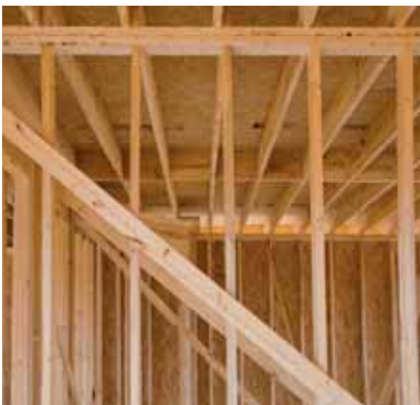
Hausbau in den USA: Verwendung von Holzprodukten für Wände, Dächer und Unterkonstruktionen
